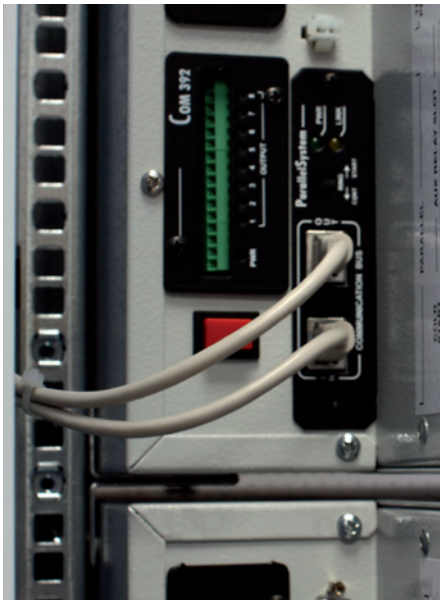
Gniazdo na kartę pracy równoległej oraz programowalną płytkę przełącznikową
